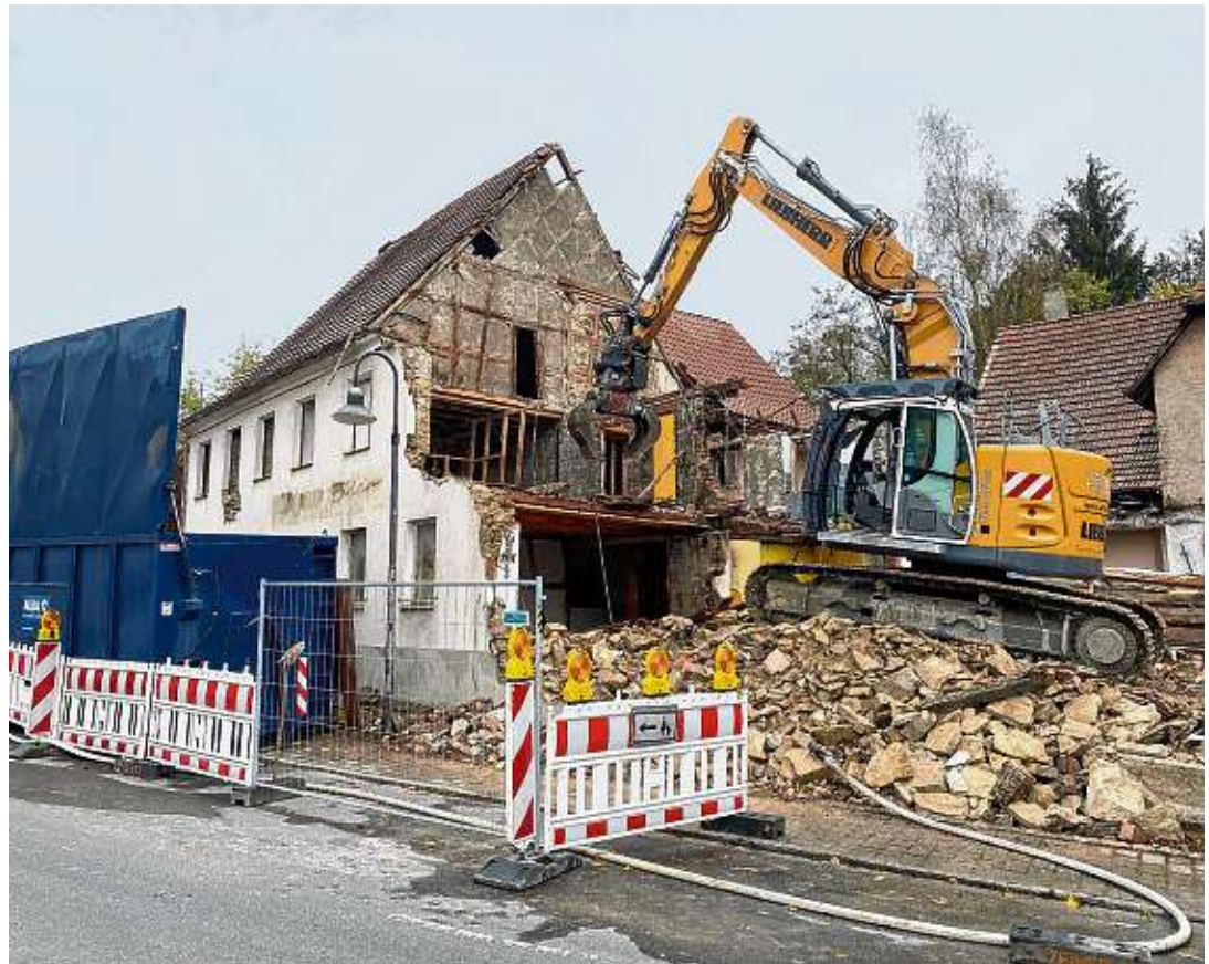
Im Gasthof »Krone«, dem einst dörflichen Zentrum Anselfingens, erlebten Jung und Alt Taufe, Hochzeit und Trauerfeiern. Nach der Schließung des Gasthauses »Krone« kaufte die Stadt Engen 2011 das Anwesen. Derzeit laufen die Abrissarbeiten, damit das Grundstück für eine neue Nutzung zur Verfügung steht.
